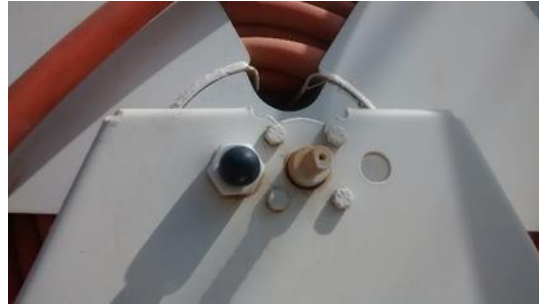
Figura - Exemplo da trava e do recolhimento dos mangotinhos por manivela do carretel.
